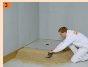
3 Variante 1a: Um das Duschelement wird in Höhe des überstehenden Falzes ein ca. 200 mm breiter Damm geschüttet – als Auflage für das Abziehen der restlichen Fläche
