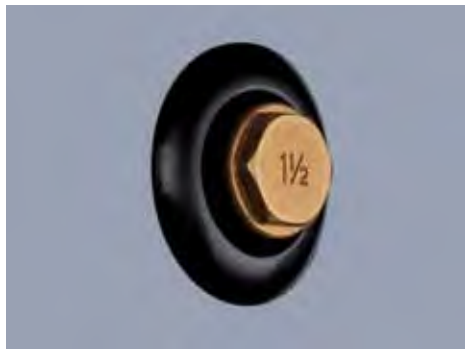
Heizungsanschluss ohne Abdeckkappe
