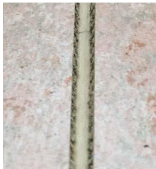
Keine Fräsung, sondern „auf Lücke verlegt“ Keine Haftung
