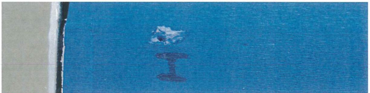
Abbildung 2: Wassereintritt der Klasse I gemäß ÖNORM B 3647 nach der Prüfung
