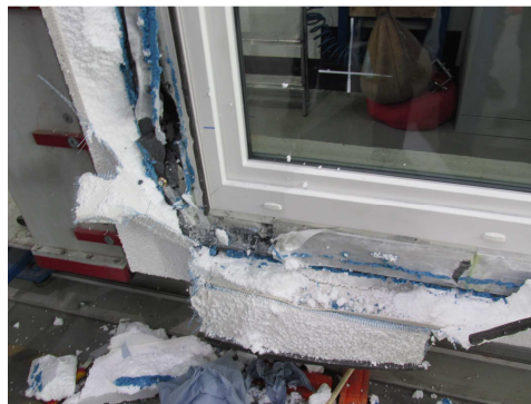
Bild 3 Schäden aus der manuellen Prüfung der Elementanbindung
